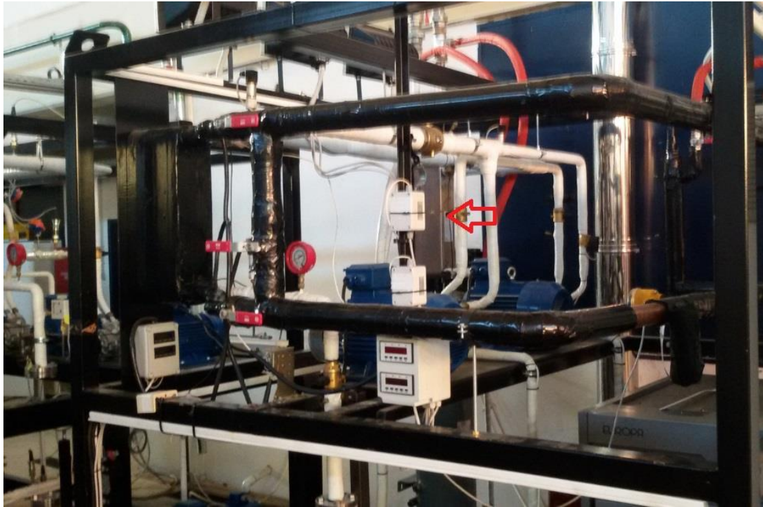
Εικόνα 2.4.7: Συμπυκνωτής στο κύκλωμα ORC της εγκατάστασης
