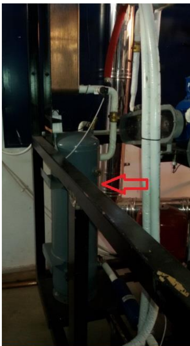
Εικόνα 2.4.8: Τροφοδοτικό δοχείο στο κύκλωμα ORC της εγκατάστασης.
