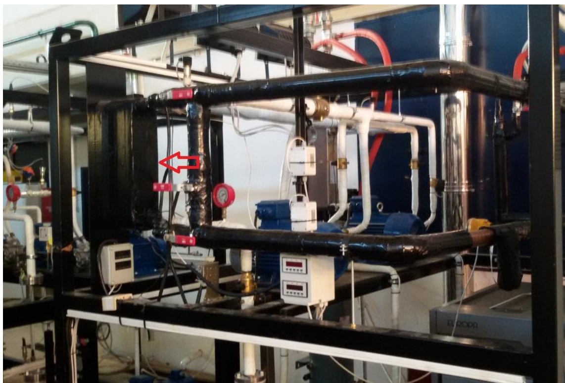
Εικόνα 2.4.6: Ατμοποιητής στο κύκλωμα ORC της εγκατάστασης
