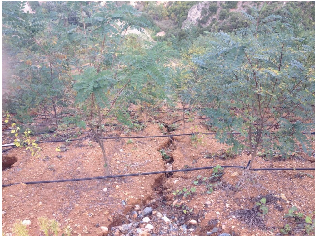
Εικόνα 54: Φαινόμενα διάβρωσης του εδάφους.
