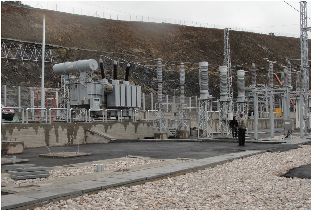
Φωτογραφία 6.2 - Επίστρωση Υποσταθμού με χαλίκι κατάλληλης διαμέτρου και με άσφαλτο για την εξάλειψη των επικίνδυνων βηματικών τάσεων και τάσεων επαφής στην περιοχή εγκατάστασης του Η/Μ εξοπλισμού.
