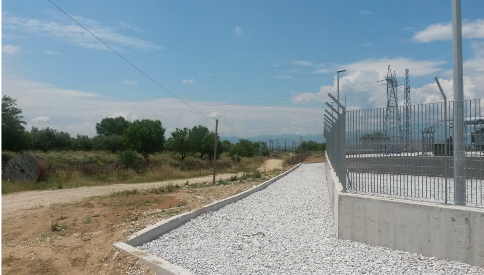
Φωτογραφία 6.4 - Τοποθέτηση χαλικιού πλάτους σε μια ζώνη 2 μέτρων εξωτερικά της περίφραξης του Υ/Σ για την εξάλειψη των επικίνδυνων βηματικών τάσεων και τάσεων επαφής.
