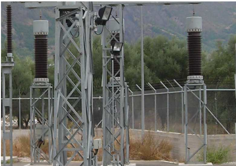
Φωτογραφία 6.6 - Εγκατάσταση πολυκαρμπονικού υλικού στην περίφραξη του Υποσταθμού για την αποφυγή επαφής με μεταλλικά μέρη της περίφραξης.
