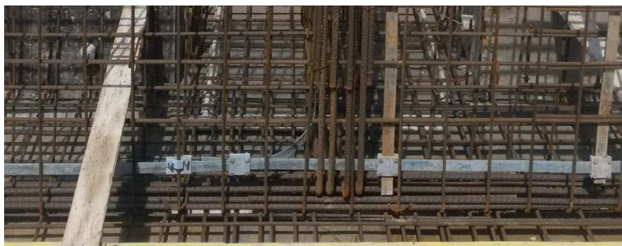
Φωτογραφία 3.2 - Θεμελιακή γείωση κτιρίου ελέγχου Υποσταθμού
