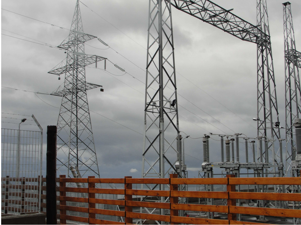
Φωτογραφία 6.7 -Εγκατάσταση ξύλινης περίφραξης για αποκλεισμό πρόσβασης σε περιοχές του Υ/Σ όπου εμφανίζονται επικίνδυνες βηματικές τάσεις και τάσεις επαφής.
