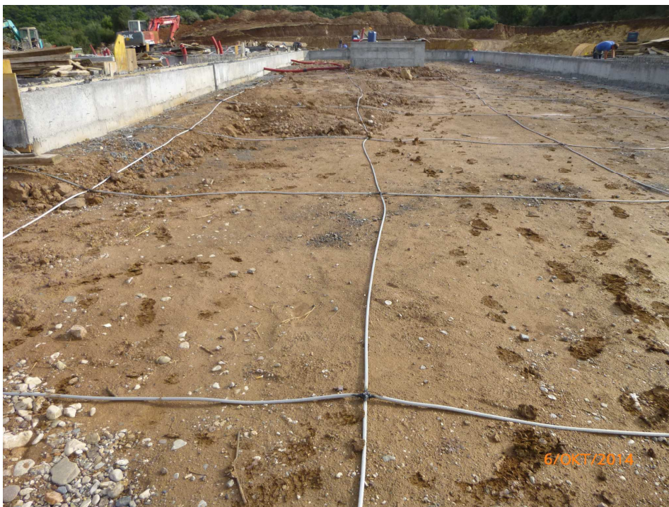
Φωτογραφία 3.1 - Πλέγμα γείωσης Υ/Σ, θα πληρωθεί με χώμα πάχους 60 cm
