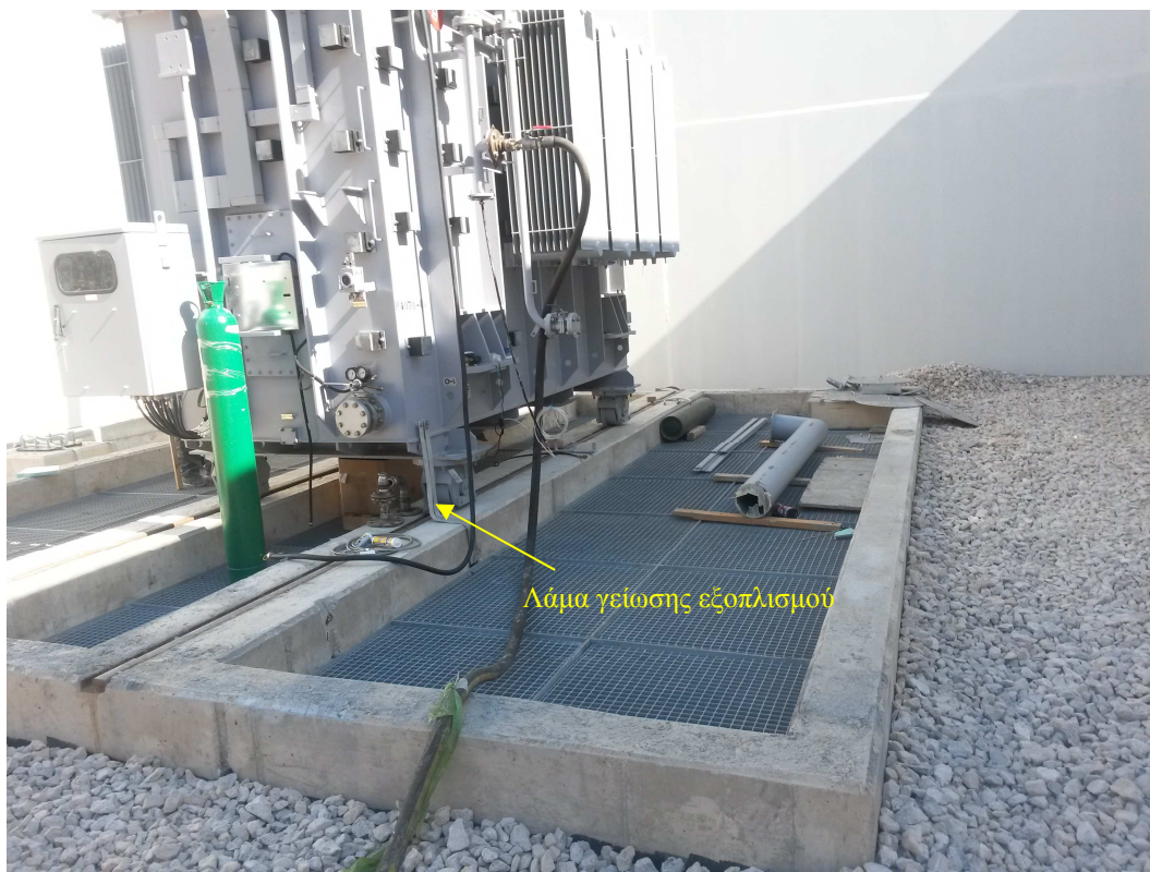
Φωτογραφία 6.3 - Γείωση εξοπλισμού του Υποσταθμού σε τουλάχιστον δύο σημεία για την εξάλειψη των επικίνδυνων τάσεων επαφής
