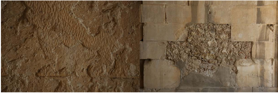
Τμήματα της εσωτερικής επιφάνειας του τοίχου του σηκού: νότιος τοίχος, διακρίνεται βυζαντινό επίχρισμα / βόρειος τοίχος στο σημείο που είχε διανοιχθεί θύρα στους χριστιανικούς χρόνους
