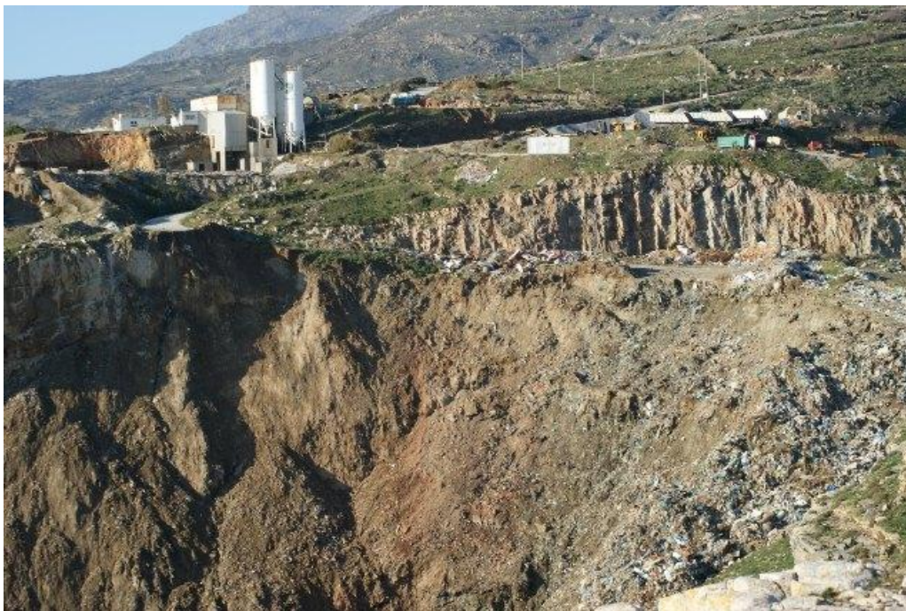
Εικόνα 7: Κατολίσθηση στο σημείο που βρισκόταν ο ΧΑΔΑ
