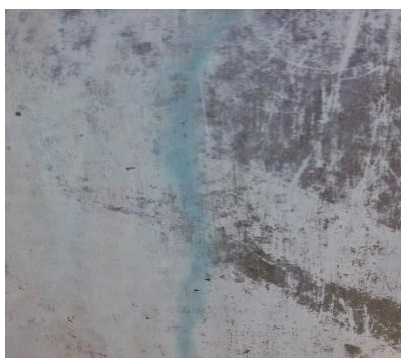
Εικόνα 241: Αποτύπωμα από ροή νερού
