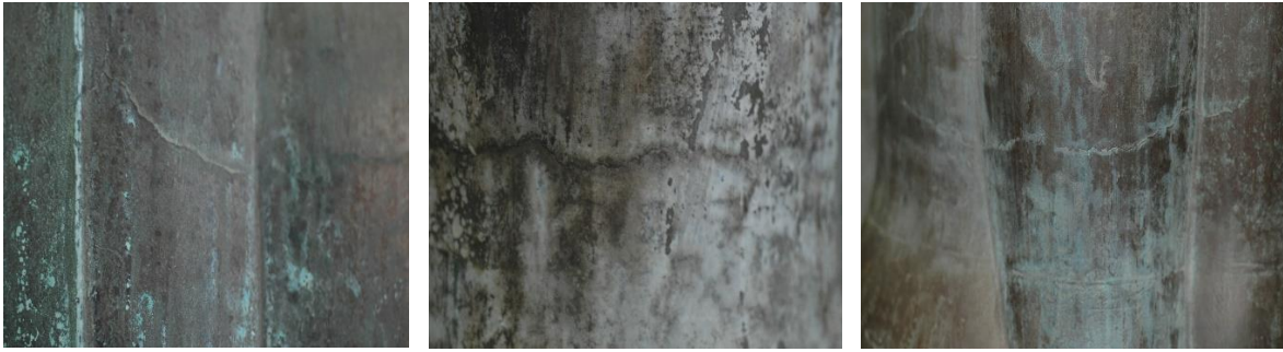
Εικόνα 101 : Μικρές ρωγμές στις επιφάνειες του γλυπτού
