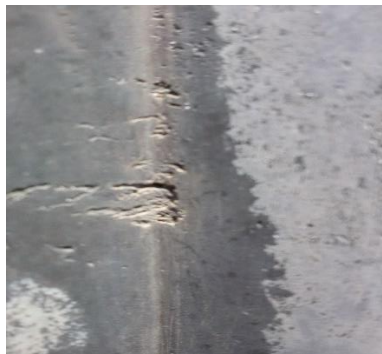
Εικόνα 204: Οπές και ρωγματώσεις
