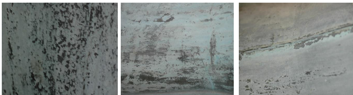
Εικόνα 98 : Υπόλευκες επικαθήσεις-προϊόντα διάβρωσης
