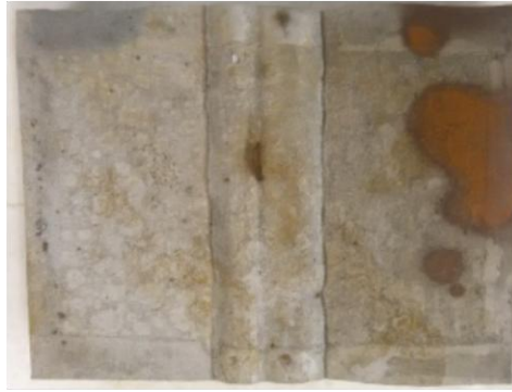
Εικόνα 5.45 γ): Δοκίμιο IIB2 μετά την απομάκρυνση των προϊόντων διάβρωσης
