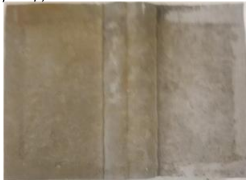
Εικόνα 5.49 γ): Δοκίμιο III B3* (interval) μετά την απομάκρυνση των προϊόντων διάβρωσης
