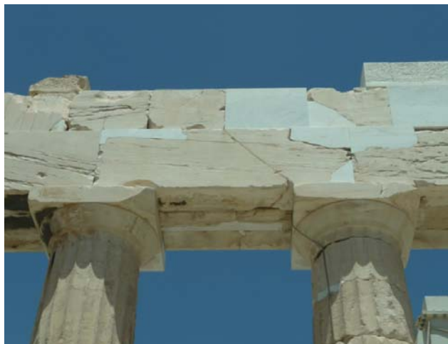
Εικόνα 10.4 Χαρακτηριστικές περιπτώσεις επιπέδων θραύσης σε αναστυλωμένα επιστύλια του Παρθενώνα.
