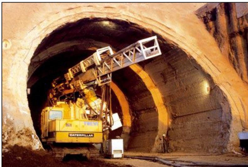
Εικόνα 5.11: Εφαρμογή pretunnel σε σιδηροδρομική γραμμή υψηλών ταχυτήτων (Ρώμη-Νάπολη Castello 1 σήραγγα) (Pietro Lunardi, 2008)
