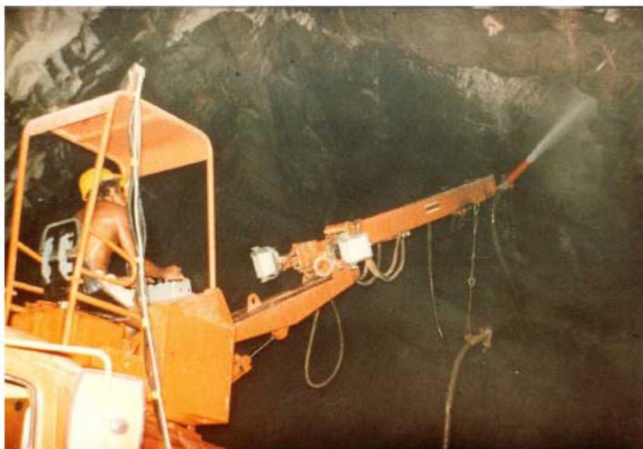
Εικόνα 5.6:Μηχανή εφαρμογής εκτοξευόμενου σκυροδέματος σε υπόγειο έργο. Η απόσταση μεταξύ του ακροφυσίου και της επιφάνειας του πετρώματος είναι περίπου στο 1 m. (Σοφιανός, 2015)
