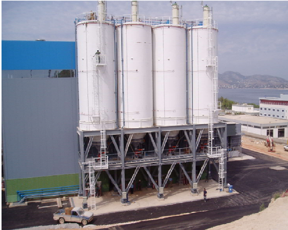
Εικόνα 3.4.6 : Σιλό προσωρινής αποθήκευσης ξηραμένης ιλύος [87]
