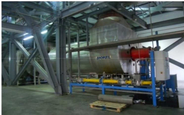
Εικόνα 3.4.5 : Καυστήρας και περιστροφικό τύμπανο για την ξήρανση της ιλύος [87]
