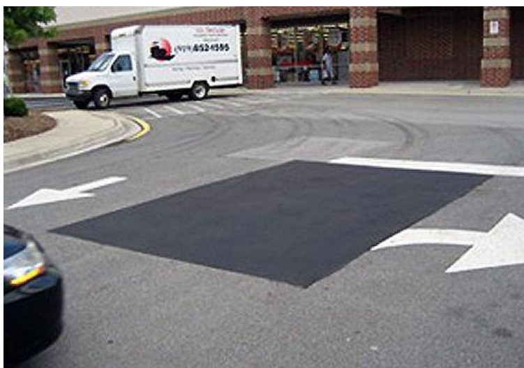
Εικόνα 4.3 Καλής ποιότητας τοπική επιδιόρθωση-μπάλωμα ασφαλτικού οδοστρώματος
