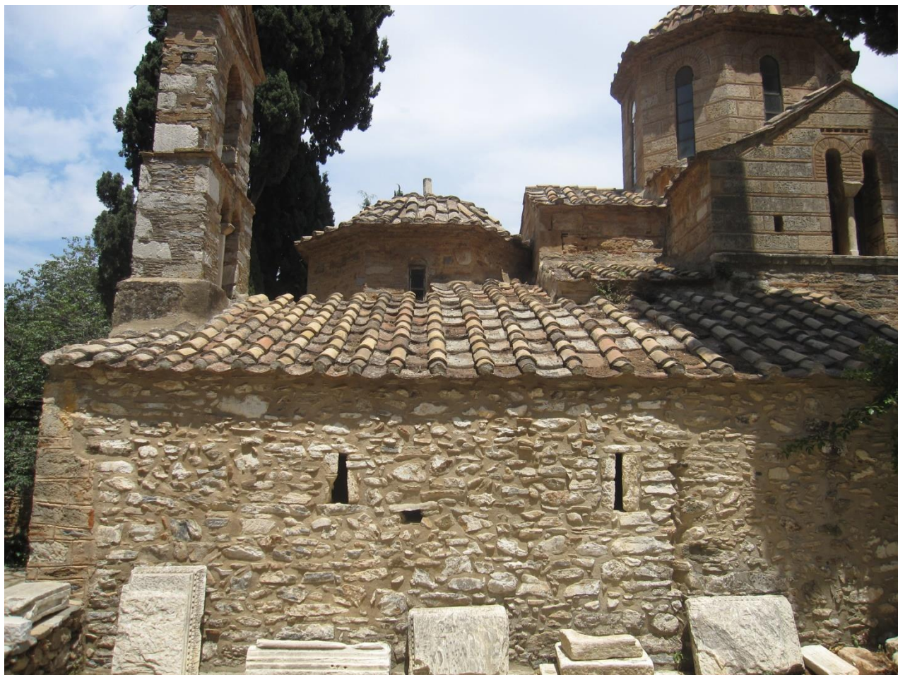
Εικόνα 2-16: Δυτική όψη του παρεκκλησίου του Αγίου Αντωνίου. Η εσοχή που διακρίνεται βρίσκεται στην προέκταση του δυτικού τοίχου του Κυρίως Ναού και είναι πιθανόν κατάλοιπο παλαιότερης οικοδομικής φάσης κατά την οποία εκεί βρισκόταν το δυτικό όριο του παρεκκλησίου.
