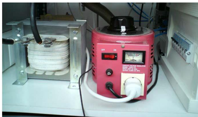
Εικόνα 4.12: Μετασχηματιστής (δεξιά) και σταθεροποιητής τάσης (αριστερά).
