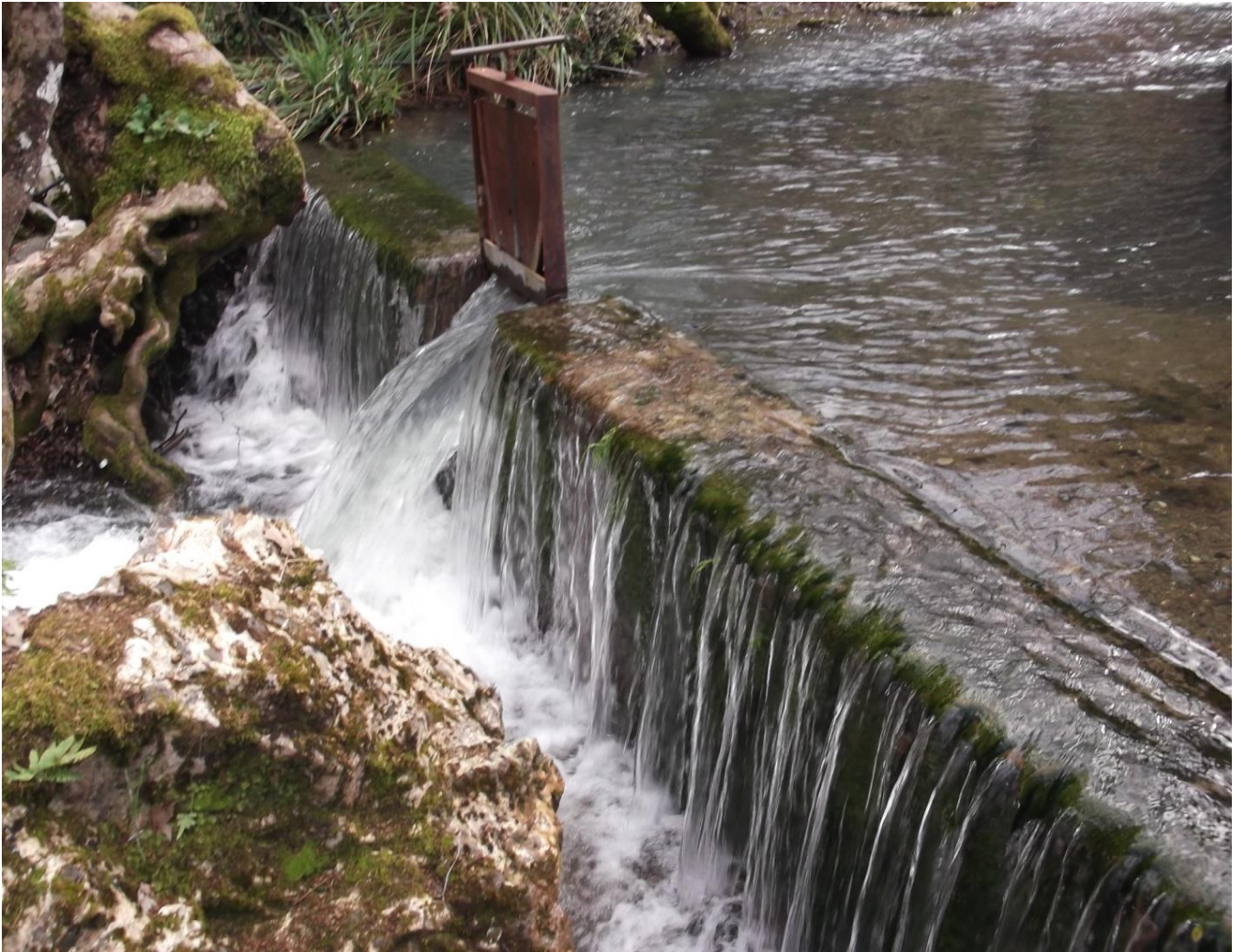
Σχήμα 5.9 Ο υπερχειλιστής στην περίπτωση που το νερό ξεπερνάει το ύψος του φράγματος
