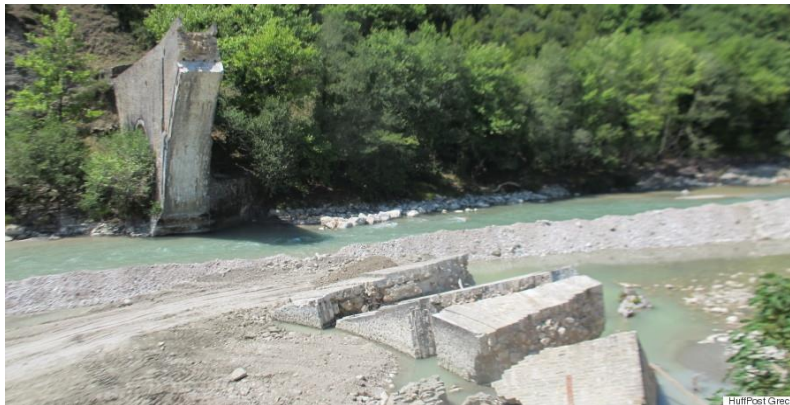
Εικ.27: Όψη της γέφυρας και των θραυσμάτων μετά την κατάρρευση της γέφυρας της 1.2.2015
