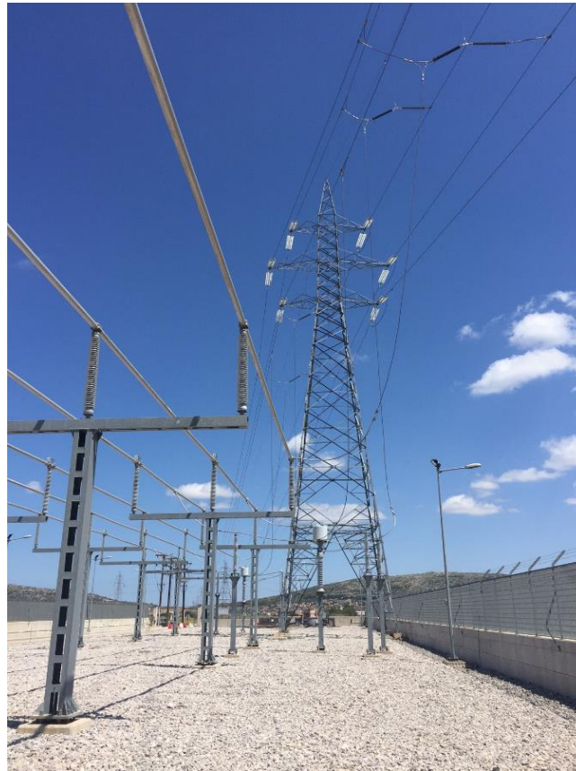
Εικόνα 5.4.7: Επιπρόσθετο επιφανειακό στρώμα από χαλίκι, τοποθετημένο σε υποσταθμό υψηλής τάσης [40].
