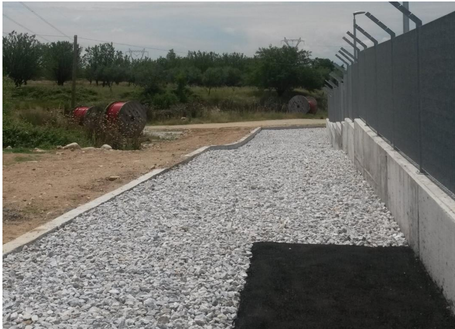
Εικόνα 6.2: Υποσταθμός Δ.Ε.Η με εξωτερική επίστρωση χαλικιού και επιπλέον προσθήκη ασφάλτου στις εξωτερικές γωνίες του υποσταθμού με στόχο την αύξηση των ορίων ασφαλείας των βηματικών τάσεων και τάσεων επαφής [40].
