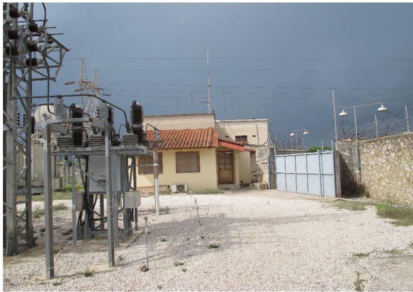
Εικόνα 6.3: Υποσταθμός Δ.Ε.Η με επιφανειακή επίστρωση χαλικιού, περίφραξη από μάντρα και προσθήκη ασφάλτου στην σιδερένια πόρτα.
