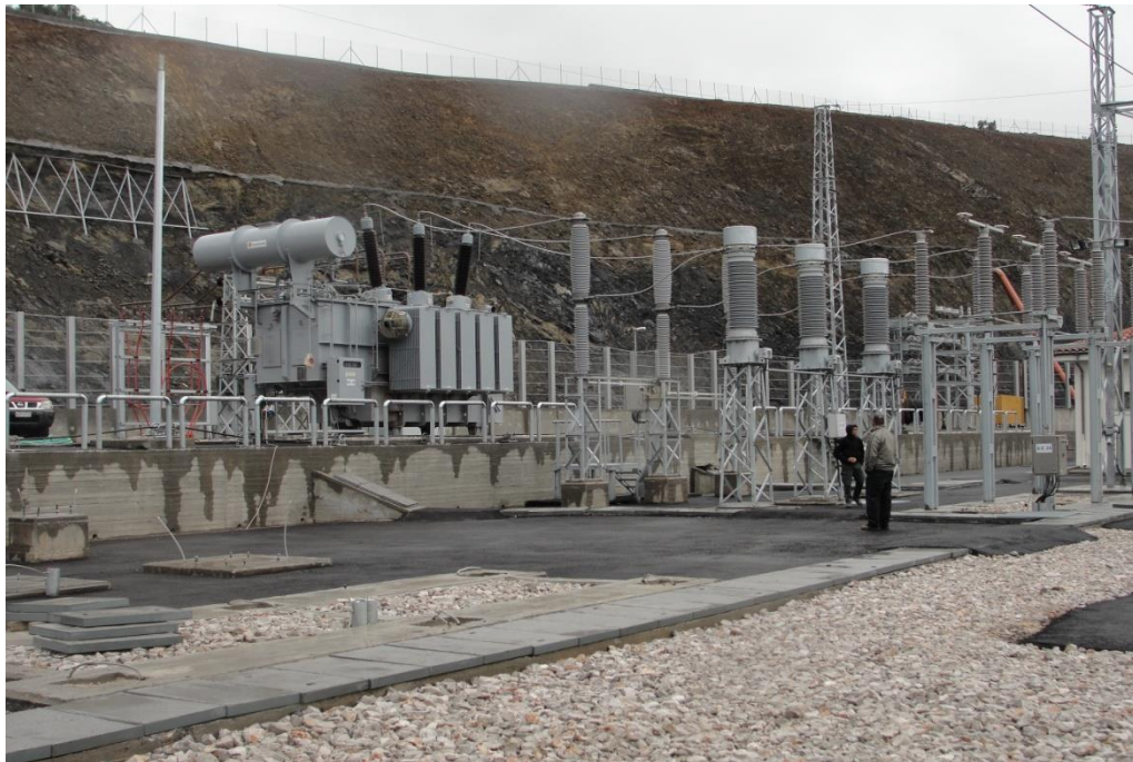
Εικόνα 5.5.15: Επίστρωση Υποσταθμού με χαλίκι κατάλληλης διαμέτρου και με άσφαλτο με στόχο τον περιορισμό κάτω των ορίων ασφαλείας των επικίνδυνων αναπτυσσόμενων τάσεων [40].
