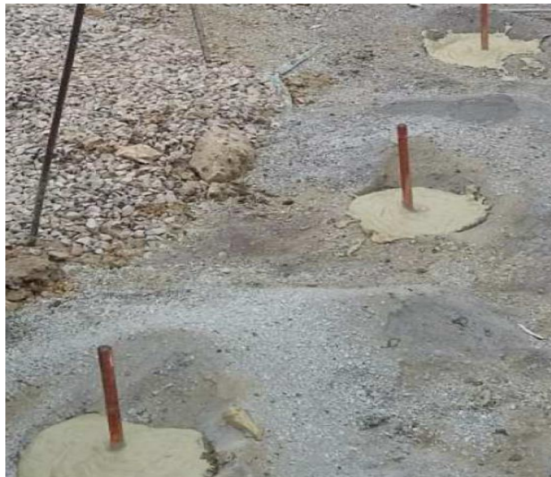
Εικόνα 5.5.7: Τοποθέτηση ράβδων γείωσης στις γωνίες της περίφραξης του υποσταθμού, με στόχο τον περιορισμό των επικίνδυνων αναπτυσσόμενων τάσεων [40].
