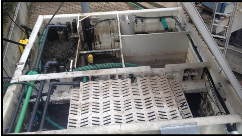
Σχήμα 4-6: Οι δεξαμενές των βιολογικών διεργασιών του συστήματος
