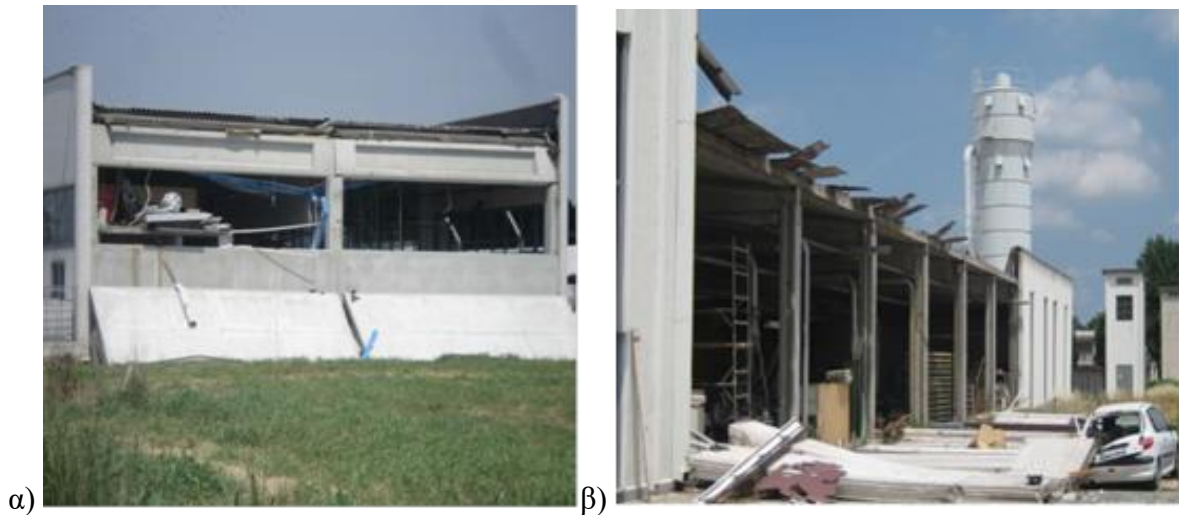
Σχ. 1.23: Αστοχία (α) οριζοντίων και (β) κατακόρυφων προκατασκευασμένων πανέλων σε μονόροφα κτίρια
