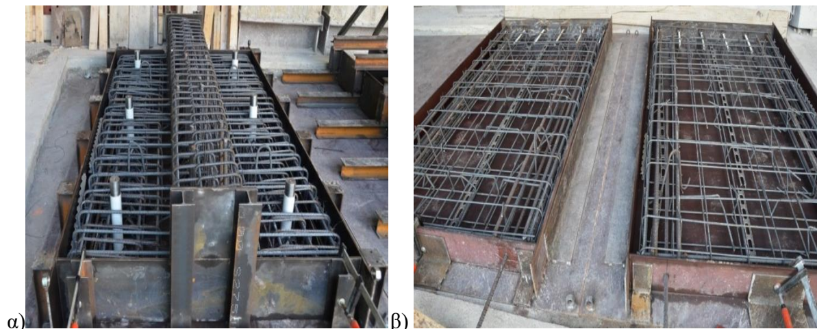
Σχ. 5.1: Τοποθέτηση οπλισμού δοκιμίων σε (α) δοκό, (β) πάνελα κατά τα πειράματα του Εργαστηρίου Αντισεισμικής Τεχνολογίας Ε.Μ.Π.[19]
