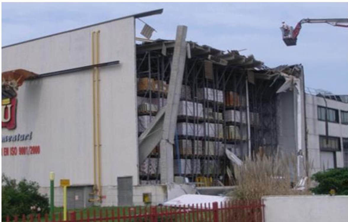
Σχ. 1.24: Κατάρρευση οροφής, δοκών, υποστυλωμάτων και πανέλων πλαγιοκαλύψεων σε πολύροφο κτίριο με επίπεδη οροφή [15]
