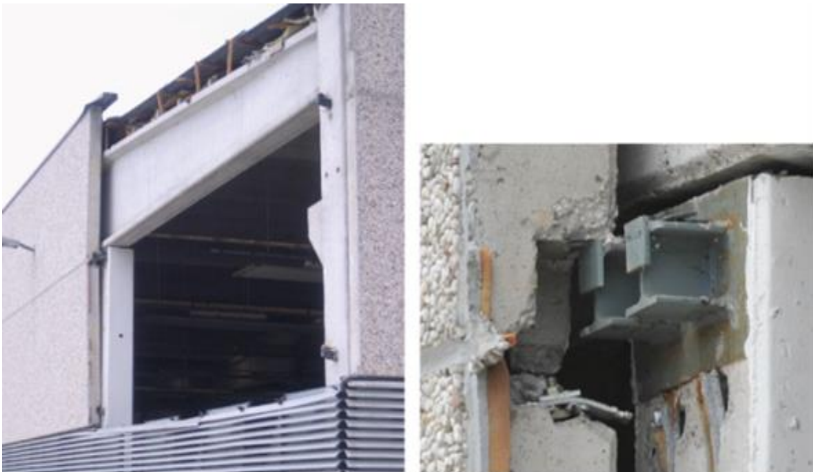
Σχ. 1.26: Αποκόλληση και εκτός-επιπέδου στροφή οριζόντιου πανέλου πλαγιοκάλυψης λόγω αστοχίας των συνδέσεων: (α) γενική άποψη, (β) λεπτομέρεια σύνδεσης που έχει αστοχήσει [15]
