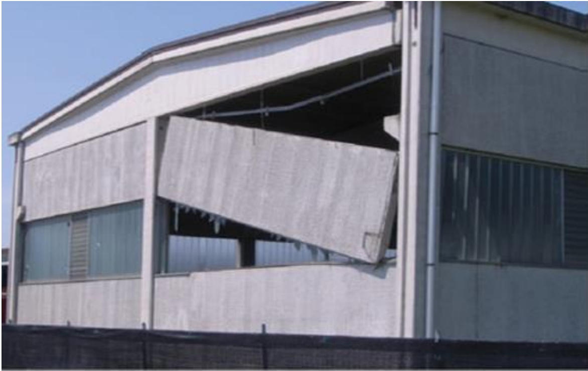
Σχ. 1.25: Αποκόλληση και εντός-επιπέδου στροφή οριζόντιου πανέλου πλαγιοκάλυψης λόγω αστοχίας των συνδέσεων [15]
