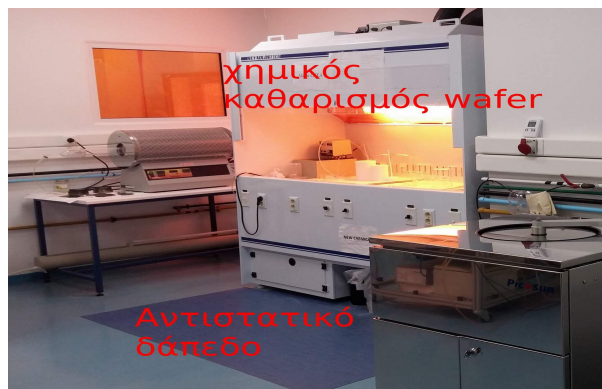
Εικόνα 24: Χώρος χημικού καθαρισμού, clean room.
