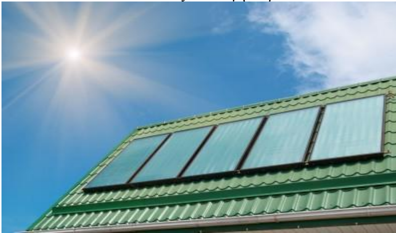
Εικόνα 1.5 Ηλιακοί συλλέκτες σε στέγη κτιρίου
