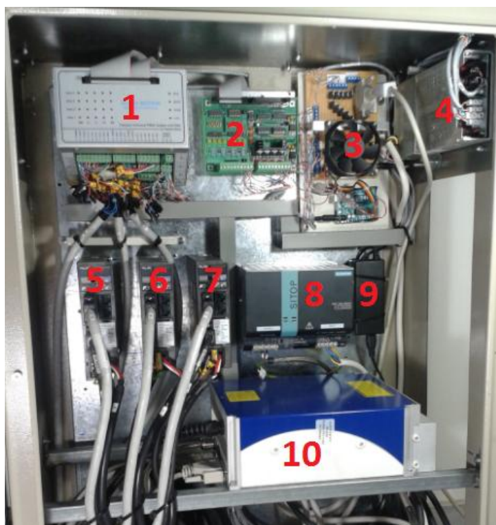
Εικόνα 2.77 Ο πίνακας ελέγχου της μηχανής
