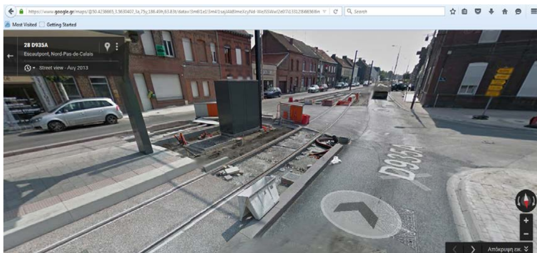
Φωτογραφία 9. Δίκτυο τραμ μονής λωρίδας με σημεία διασταυρώσεων στη Βαλενσιέν στη Γαλλία σε λειτουργία. Διακρίνεται η αποκλειστική λωρίδα που προστατεύεται με ρείθρα και από τις δύο πλευρές, η διακλάδωση μπροστά από το σταθμό και οι ειδικοί φωτεινοί σηματοδότες.
