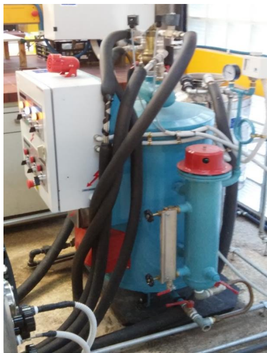
Εικόνα 25: Ο ηλεκτρικός ατμολέβητας της πρότυπης μονάδας παραγωγής αιθανόλης
