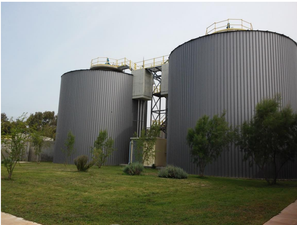
Εικόνα 6.4. Δεξαμενές ζύμωσης λάσπης
