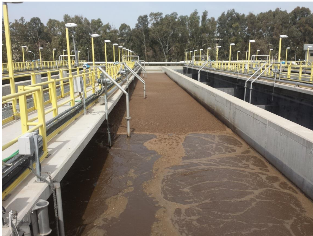
Εικόνα 6.5. Δεξαμενή βιολογικής επεξεργασίας
