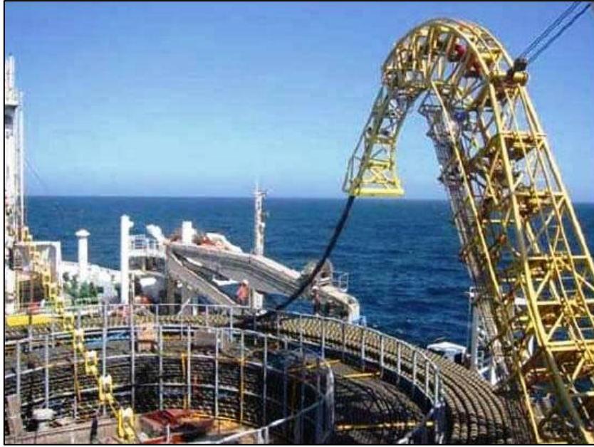
Εικόνα 2-13: Περιστρεφόμενη τράπεζα με εσωτερικό χώρισμα για ταυτόχρονη τοποθέτηση δύο καλωδίων. Εδώ, ένα υποθαλάσσιο καλώδιο ρεύματος (εξωτερικό τμήμα) και ένα καλώδιο οπτικών ινών (εσωτερικό τμήμα) είναι αποθηκευμένα στην περιστρεφόμενη τράπεζα.
