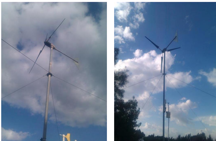
Σχήμα 2.2: Ανεμογεννήτρια εγκατεστημένη στην οροφή του Εργαστηρίου Ηλεκτρομηχανικής Μετατροπής Ενέργειας: α) Άποψη του ανεμοδείκτη, β) Άποψη του ανεμομέτρου και υγραμέτρου
