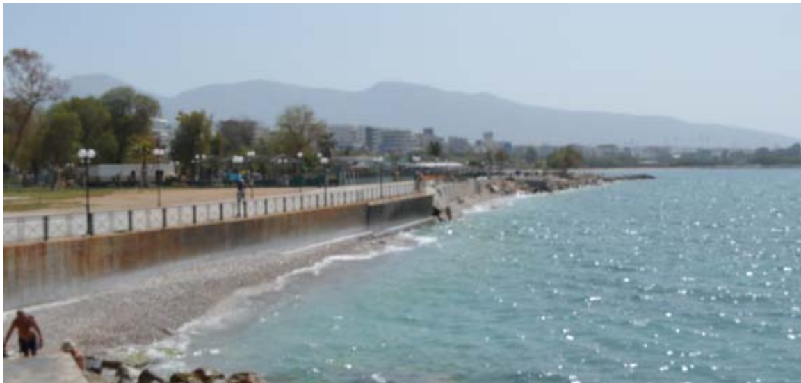
Εικόνα.10. Καταστροφή του πεζοδρόμου.
