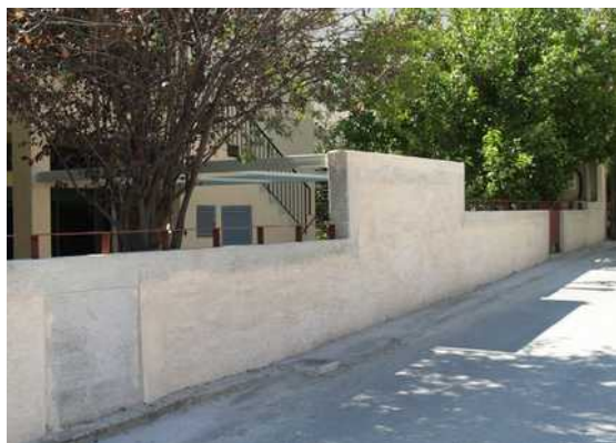
3.2.2.31 Μάντρα σε κατοικία στον Κόκκινο Μύλο. Αρχιτέκτων Γιώργος Αγγελής. Μια απλή υπερύψωση του τοίχου, στηρίζει την πέργκολα και παρέχει την απαραίτητη πλάτη που ενισχύει τον ήχο και προστατεύει από τα κοντινά βλέμματα των περαστικών.
