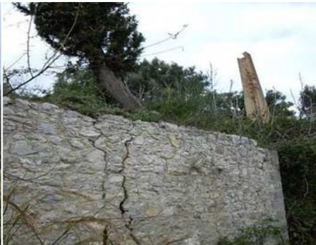
Εικόνα 0-6 Η συνέχεια του ίχνους των ερπυσμών σε πέτρινο τοίχο διαμόρφωσης αναβαθμού που ενσωματώνει το κτίσμα (Ηλία, 2013).
