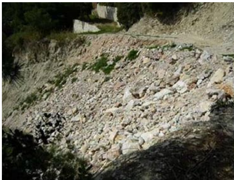
Εικόνα 0-13 Ολοκληρωτική καταστροφή του οδοστρώματος από την κατολίσθηση στο δρόμο προς Αγ. Μαρίνα (Ηλία, 2013)
