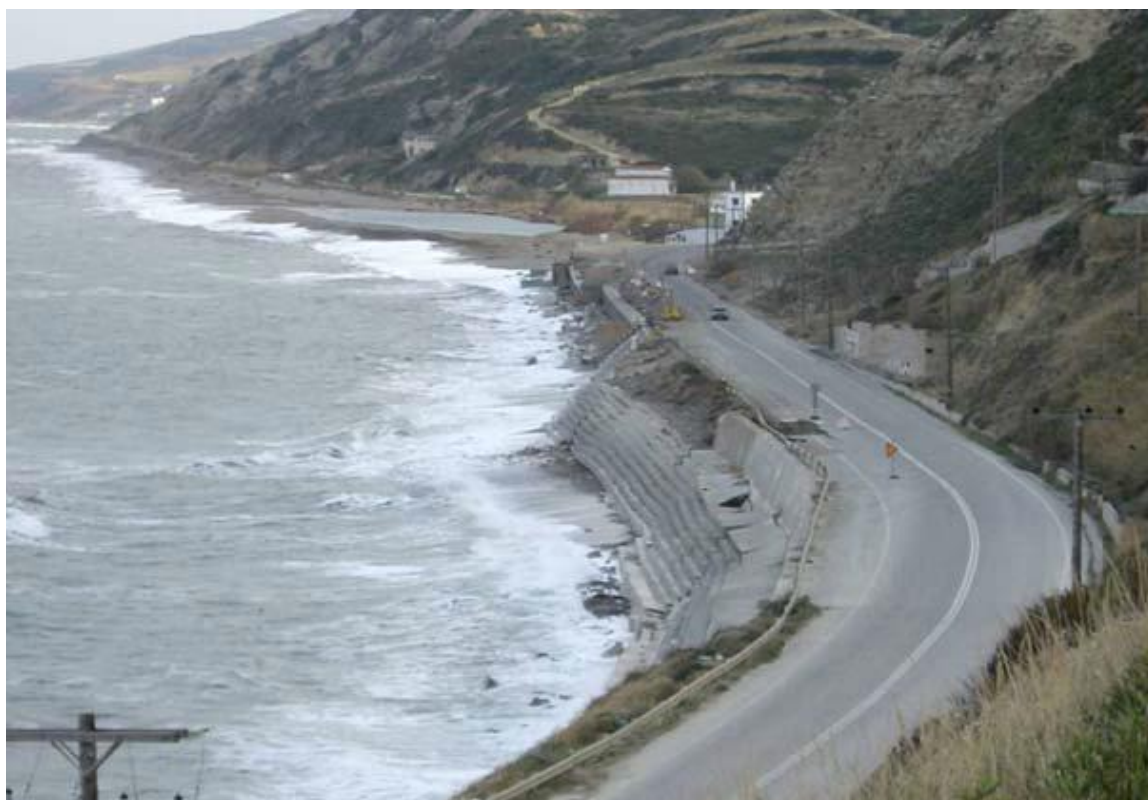
Εικόνα 0-11 Πανοραμική άποψη των αστοχιών κατάντη του δρόμου Πλατάνας - Στομίου. Στην εικόνα διακρίνεται και η πολύ μεγάλη κλίση και το ύψος των πρανών ανάντη του δρόμου (Ηλία, 2013).
