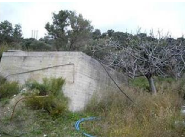
Εικόνα 0-7 Δεξαμενή νερού ανάντη του ξενοδοχείου Βαλέντι. Η δεξαμενή έχει αχρηστευτεί από τις κινήσεις (έχει υποστεί σοβαρή κλίση) (Ηλία, 2013).
