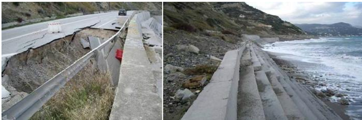
Εικόνα 0-9 Η καταστροφή του οδοστρώματος και του υποκείμενου επιχώματος του δρόμου λόγω των υποσκαφών του κυματισμού (Ηλία, 2013).
