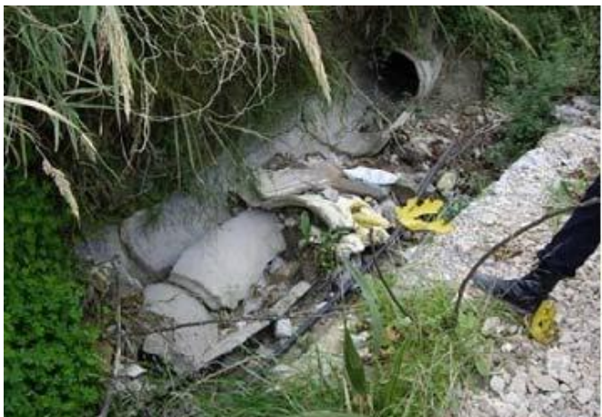
Εικόνα 0-8 : Κατεστραμμένος αγωγός ομβρίων με αποτέλεσμα την ανεξέλεγκτη ροή στα εδαφικά υλικά (εμποτισμός – κορεσμός) (Ηλία, 2013).
