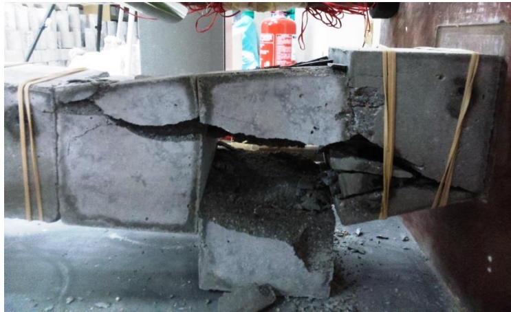
Σχήμα 7.65. Διακρίνεται η πίσω πλευρά της δοκού μετά την τελική αστοχία.
