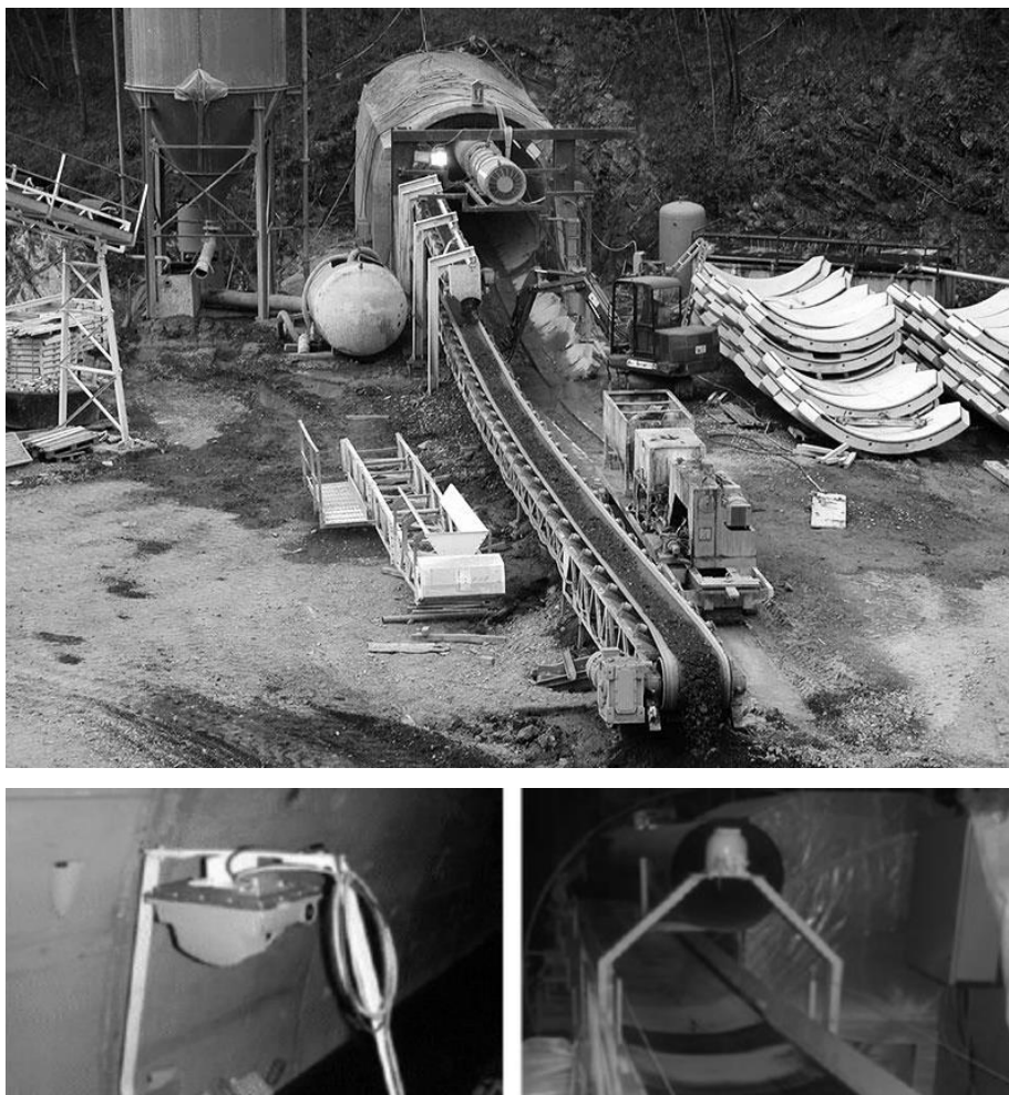
Εικόνα 2-22: Ταινιόδρομος μεταφοράς εξορυγμένου υλικού (πάνω) και διατάξεις σαρωτών λέιζερ (κάτω)
