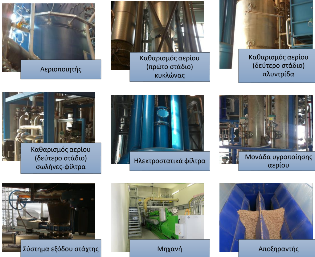
Εικόνα 55: Μέρη εγκατάστασης αεριοποιητή PYROX
