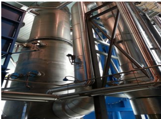
Εικόνα 74: Μονάδα καθαρισμού αερίου
