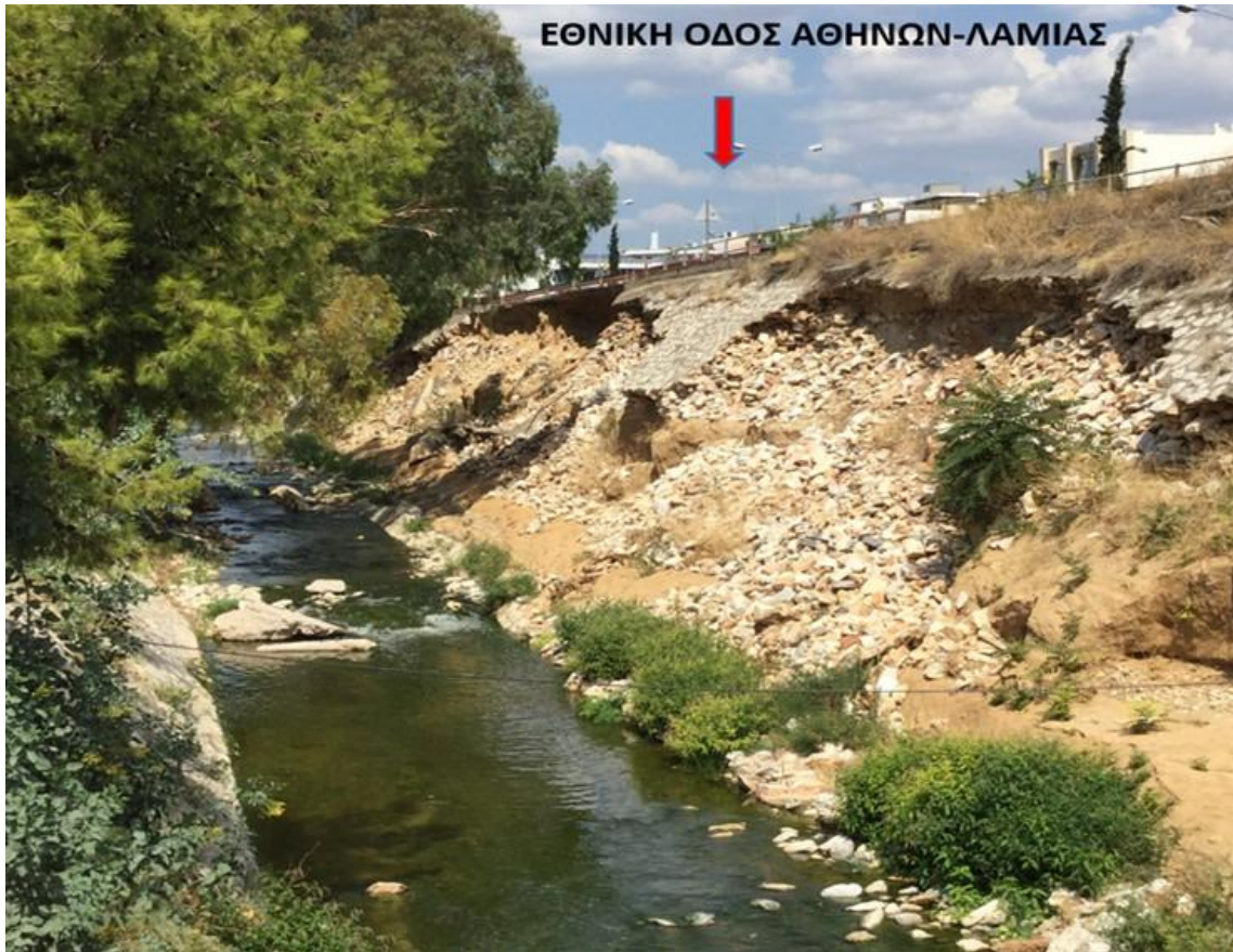
Εικόνα 2.11: Καταστροφή ανατολικού πρανούς στη συμβολή της εξόδου ΠΑΘΕ προς τη Λ. Κατσώνη.
