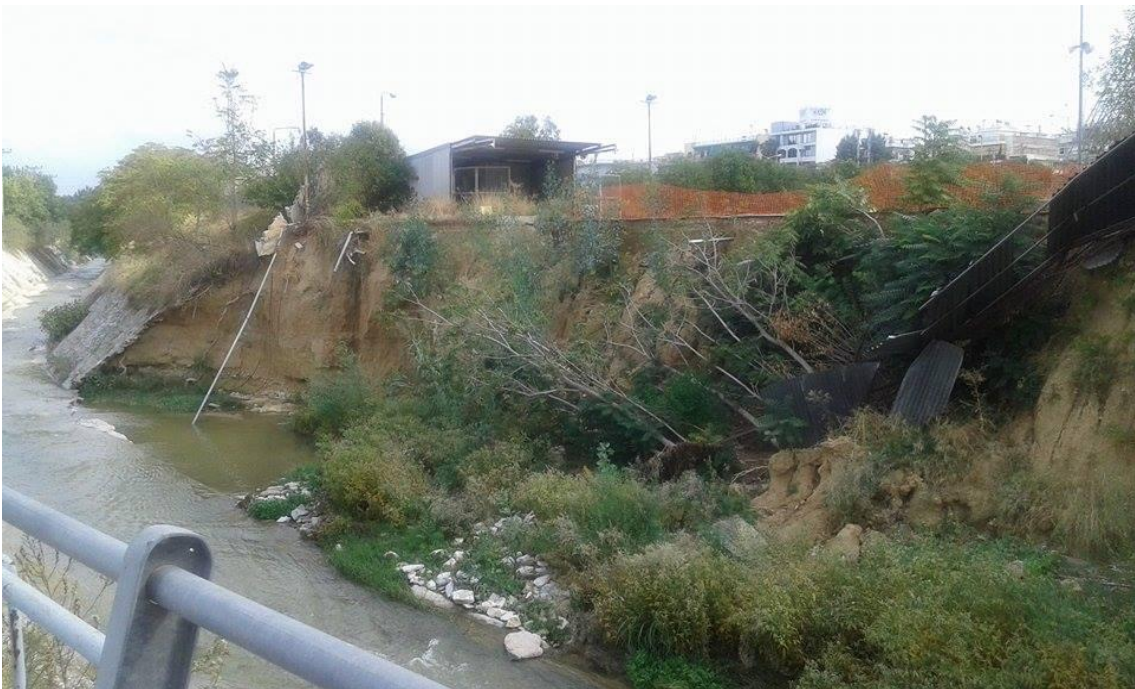
Εικόνα 2.8: Αποκόλληση λιθένδυσης στο εσωτερικό της αλλαγής διεύθυνσης.
