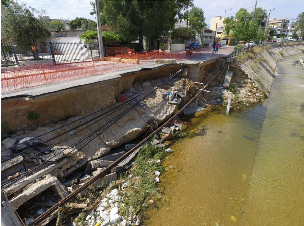
Εικόνα 2.10: Καταστροφή δυτικής όχθης, αποξήλωση πεζοδρομίων, στηθαίων ασφαλείας και φρεατίων.
