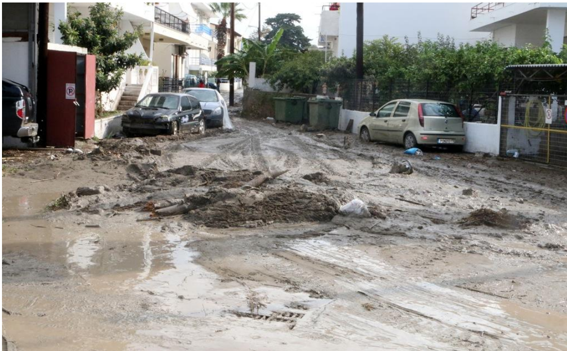
Εικόνα 2.1: Καταστροφές οδικών δικτύων στο Δήμο Αγ. Αναργύρων, 22/10/2015.
