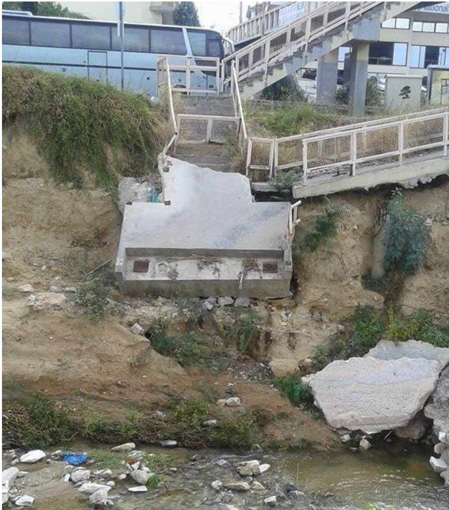
Εικόνα 2.13: Υποσκαφή της θεμελίωσης της πεζογέφυρας που ενώνει τις οδούς Φλαβιανών και Λάμπρου Κατσώνη.
