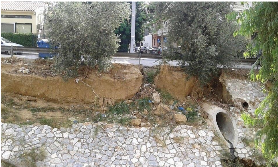
Εικόνα 2.7: Καταστροφή λιθένδυσης λόγω εκρίζωσης φυτών.
