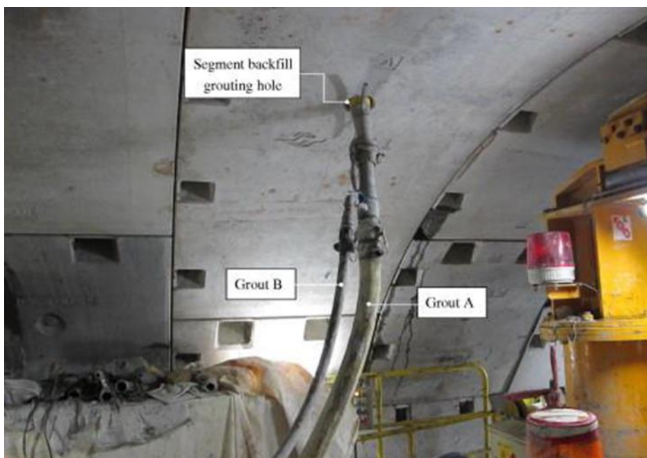
Εικόνα 2.15: Εισπίεση ενέματος μέσα από έτοιμα ανοίγματα που υπάρχουν στα προκατασκευασμένα στοιχεία (Robbins n.d.).
