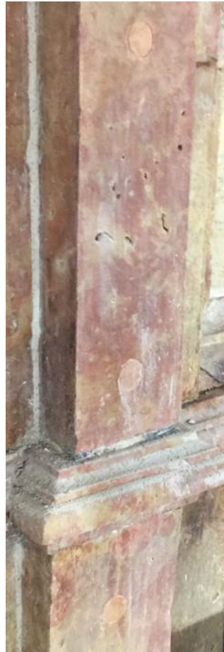
Εικόνα 67. Τοποθετημένα ευθύγραμμα αγκύρια σε κολώνα. Με δυσκολία διακρίνονται οι τάρες που κρύβουν τις οπές τους.
