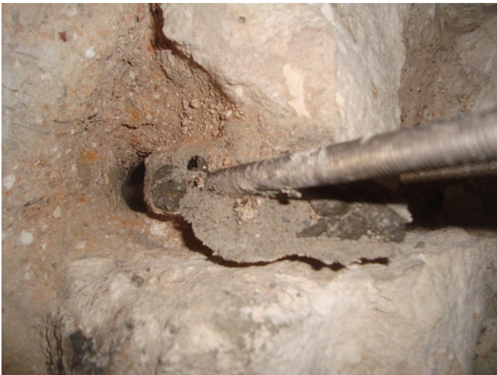
Εικόνα 57. Ολίσθηση της ράβδου επί του MASTERFLOW 980 και μερική αποκόλληση του MASTERFLOW 980 από την τοιχοποιία Πηγή: Προσωπικό αρχείο
