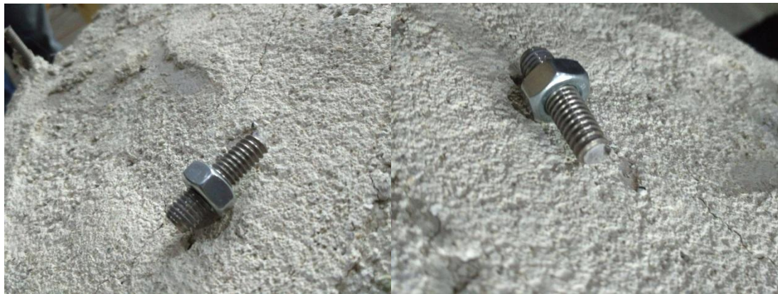
Εικόνα 59. Η διαρροή της ράβδου στο σπείρωμα Πηγή: Προσωπικό αρχείο
