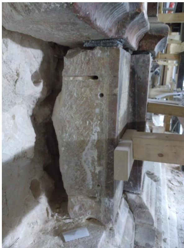
Εικόνα 33.Οπές στις κατώτερες πλάκες της ορθομαρμάρωσης για την τοποθέτηση των βλήτρων και των αγκυρίων.
