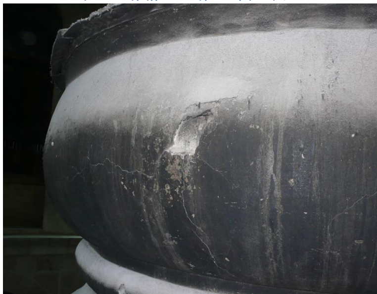
Εικόνα 3.19: Επιφανειακές ρηγματώσεις και αποκόλληση του επιχρίσματος.
