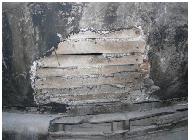
Εικόνα 3.16: Σημείο αποκόλλησης επιχρίσματος από τα όμβρια ύδατα - Φανερώνεται το μπαγδατί εσωτερικά.
