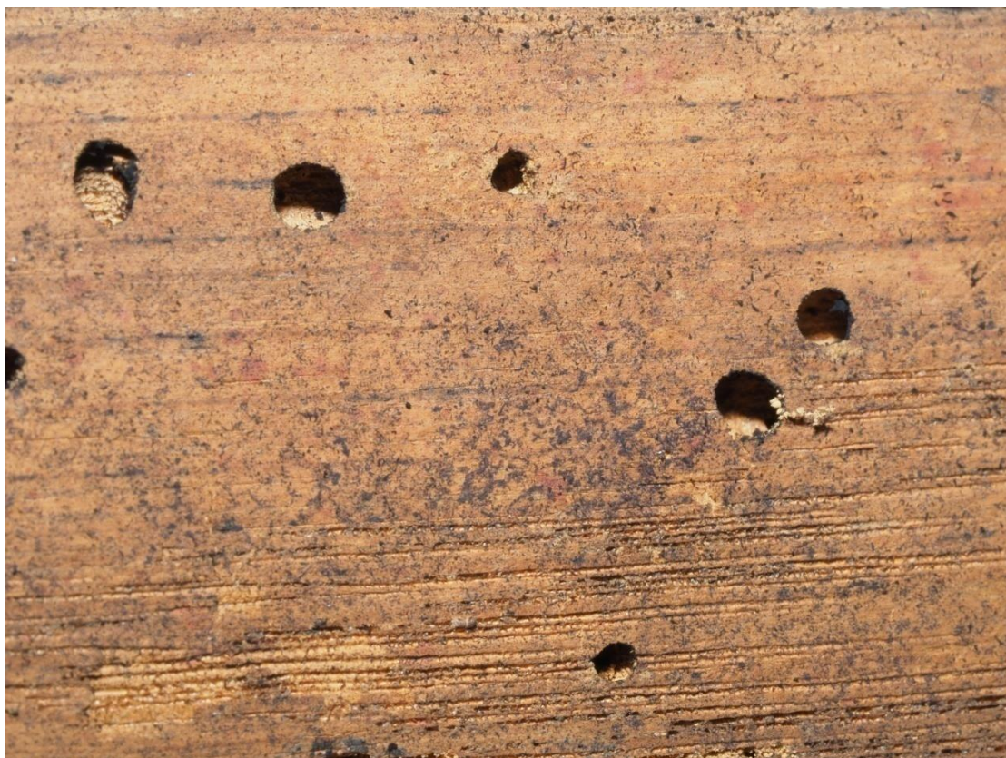
Εικόνα 6.10: Οπές διατομών 2-4 mm από ξυλοφάγα έντομα, που οδηγούν σε ανενεργές στοές.
