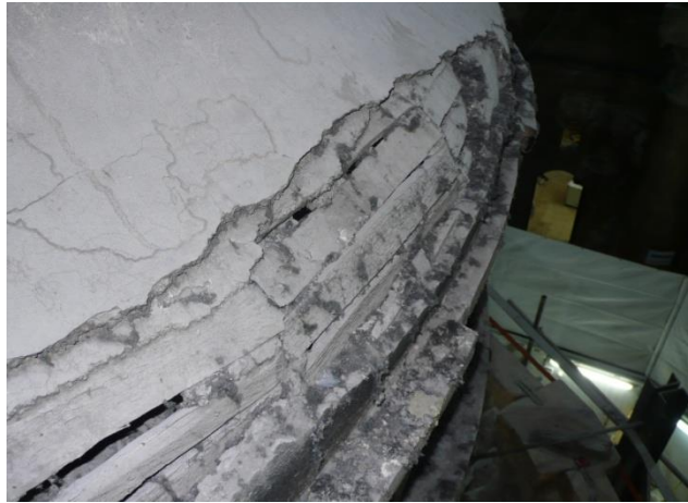
Εικόνα 3.17: Κατεστραμμένο επίχρισμα από τα όμβρια ύδατα - Φανερώνεται το μαγαδατί εσωτερικά.
