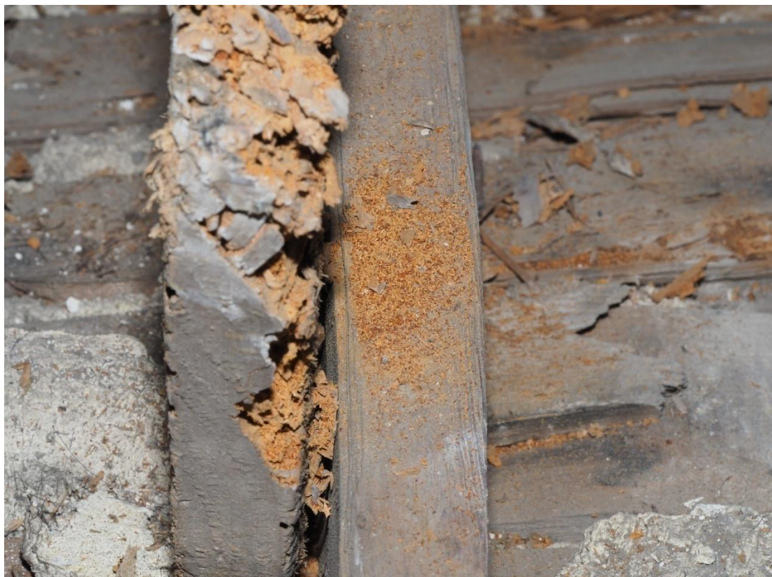
Εικόνα 6.13: Περιπτώματα ξυλοφάγων εντόμων και ξύλο εμφανώς σε άσχημη κατάσταση.
