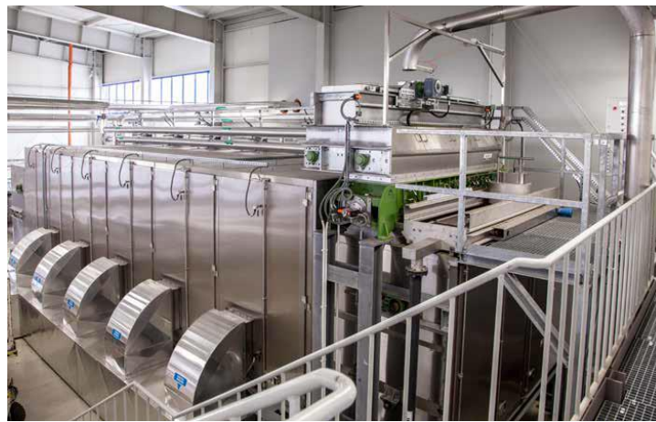
Εικόνα 3-7: Ξηραντήρας Μεταφορικής Ταινίας (Πηγή: Haarslev)
