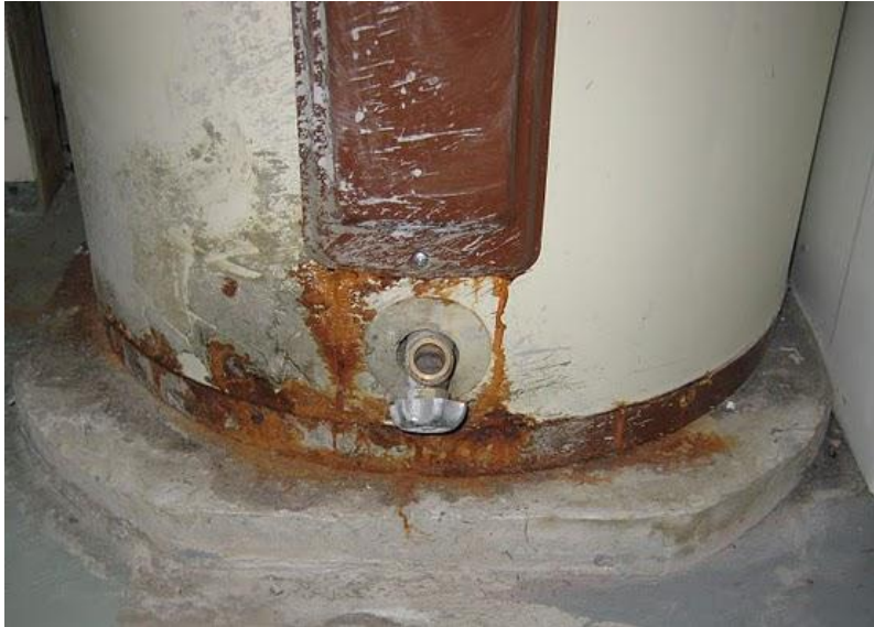
Εικόνα 2.22: Τυπική Βλάβη Ηλεκτρικού Θερμοσίφωνα
