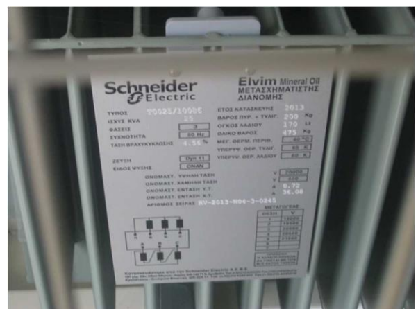
Φωτογραφία. 10: Πινακίδα Μετασχηματιστή ιδιοκαταναλώσεων
