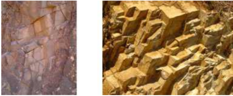
Σχήμα 1 Συνήθεις ρωγματομένες βραχώμαζες (Critical review of Eurocode-7 regarding rock mass characterization, A.M. Ferrero, A.I. Sofianos, L.R. Alejano)
