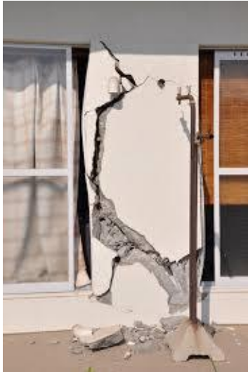
(α) Διατμητική αστοχία και λυγισμός θλιβόμενων ράβδων
