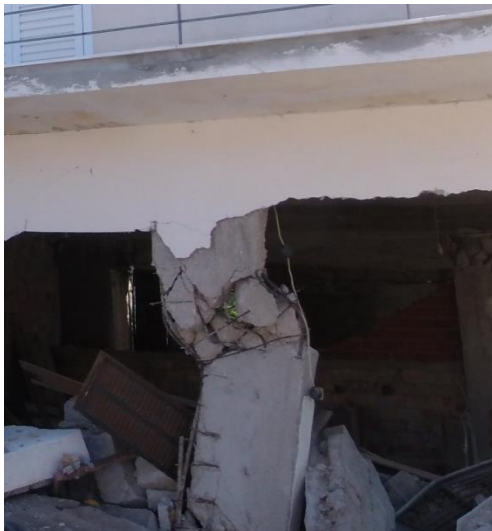
(γ) Πλήρης αποδιοργάνωση τοιχίου (αποδιοργάνωση σκυροδέματος – λυγισμός ράβδων)
