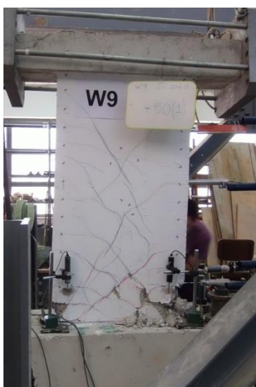
(α) Ρωγμές για μετακίνηση +50mm – Μπροστά όψη
