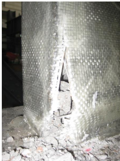
Σχήμα 5.11 Σκίσιμο FRP στη γωνία του δοκιμίου W_3\text{-FRP}
