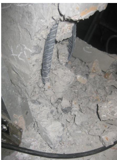
Σχήμα 4.19 Λυγισμός σπλισμού στην θλιβόμενη περιοχή δοκιμίου W_5
