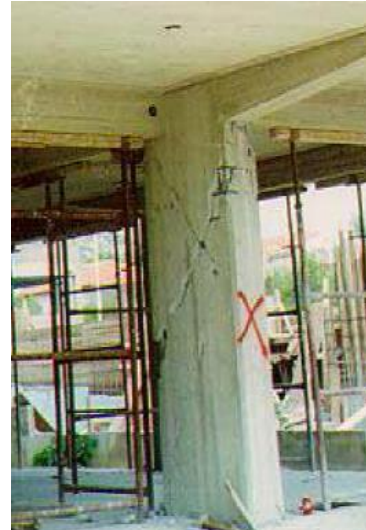
(β) Διατμητική αστοχία (χιαστί ρωγμές) περίπου στο μέσο του τοιχίου
