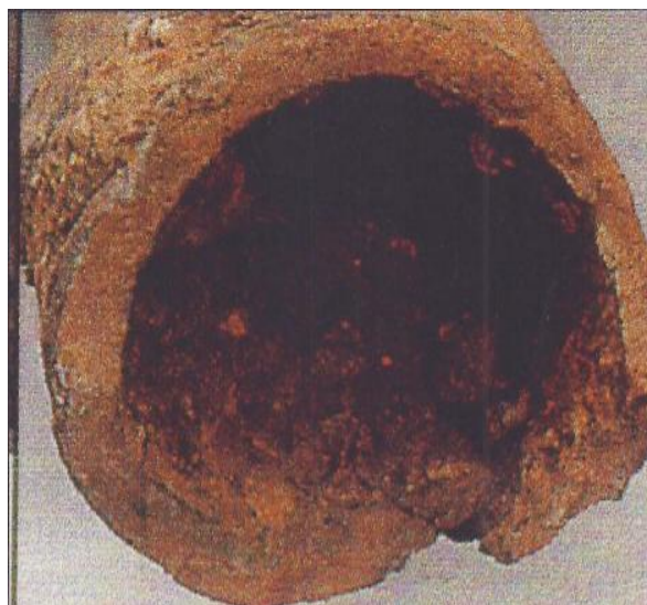
Σχήμα 4.5: Αγωγός που έχει υποστεί εσωτερική και εξωτερική διάβρωση (Κανακούδης, 1998).
