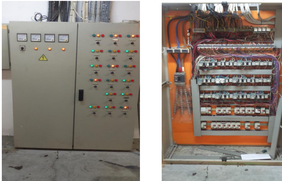
Εικόνες 3.6: Φωτογραφίες του πίνακα, στον οποίο συνδέθηκε το όργανο Fluke 1735
