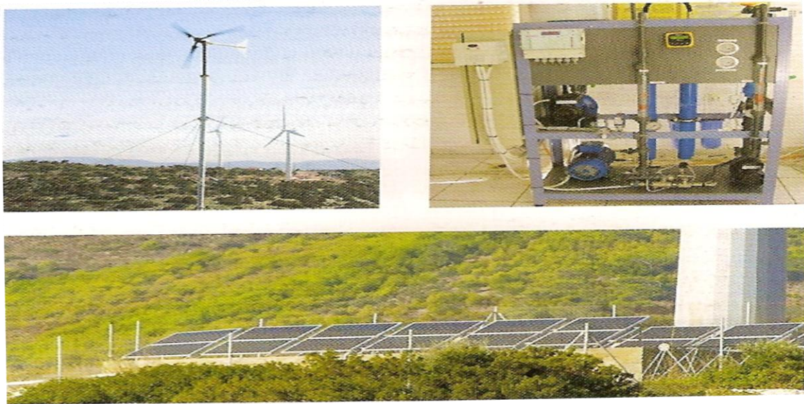
Εικόνα 2.1 Ανεμογεννήτρια 900 W και μια συστοιχία φ/β τροφοδοτούν την αυτόνομη μονάδα αφαλάτωσης του Κ.Α.Π.Ε., εγκατεστημένη στο Πάρκο Ενεργειακής Αγωγής
