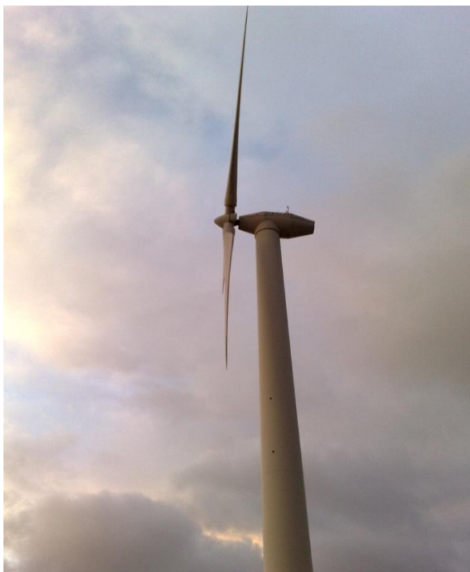
Εικόνα 4.5 Ανεμογεννήτρια NEG MICON 300kW που λειτουργεί από το 2000 στη περιοχή Ανώνυμο Άνω Μεράς ιδιοκτησίας της Δ.Ε.Υ.Α. Μυκόνου
