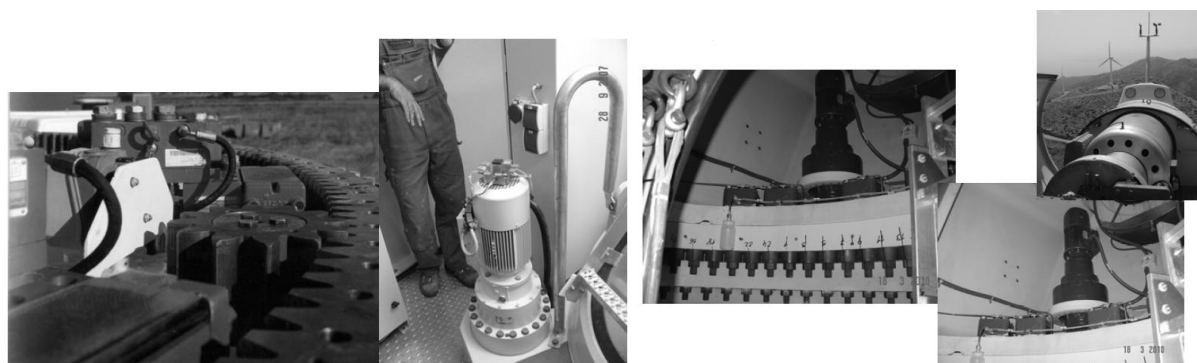
Εικόνα 3.9 Το σύστημα προσανατολισμού της ατράκτου (yaw system) όπου διακρίνονται οι ηλεκτροκινητήρες και οι οδοντωτοί τροχοί [17]
