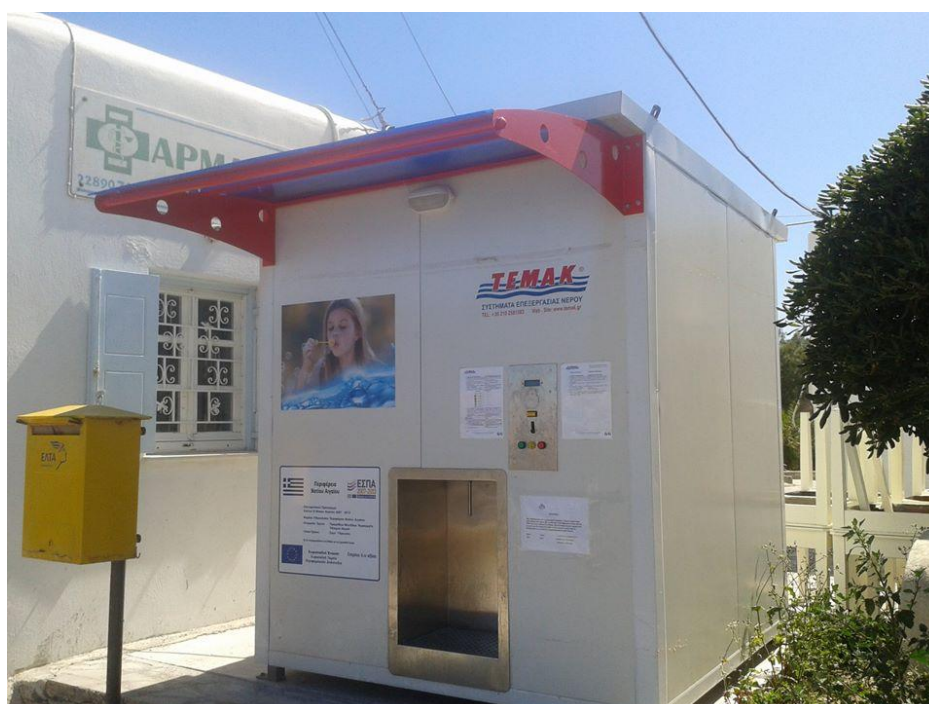
Εικόνα 4.4 Οικίσκος-μονάδα επεξεργασίας νερού του δημοτικού δικτύου ύδρευσης και βελτίωσής του σε πόσιμο
