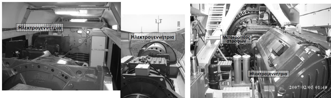
Εικόνα 3.7 Ασύγχρονες ηλεκτρογεννήτριες εγκατεστημένες στην άτρακτο της Α/Γ [17]
