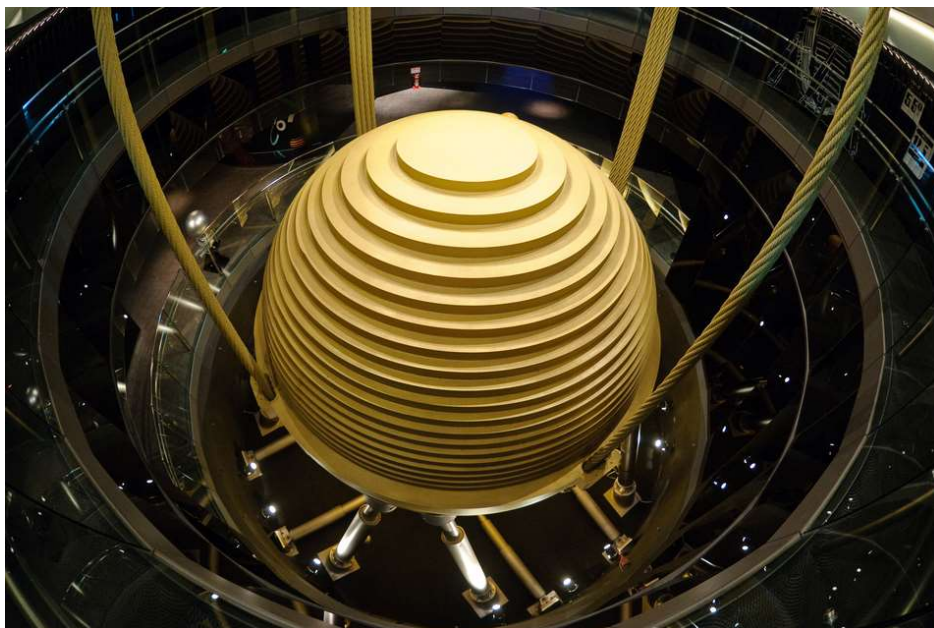
Σχ.2.8 Εικόνα του συστήματος TMD στην κορυφή του ουρανοξύστη Ταιρεί 101 Tower
