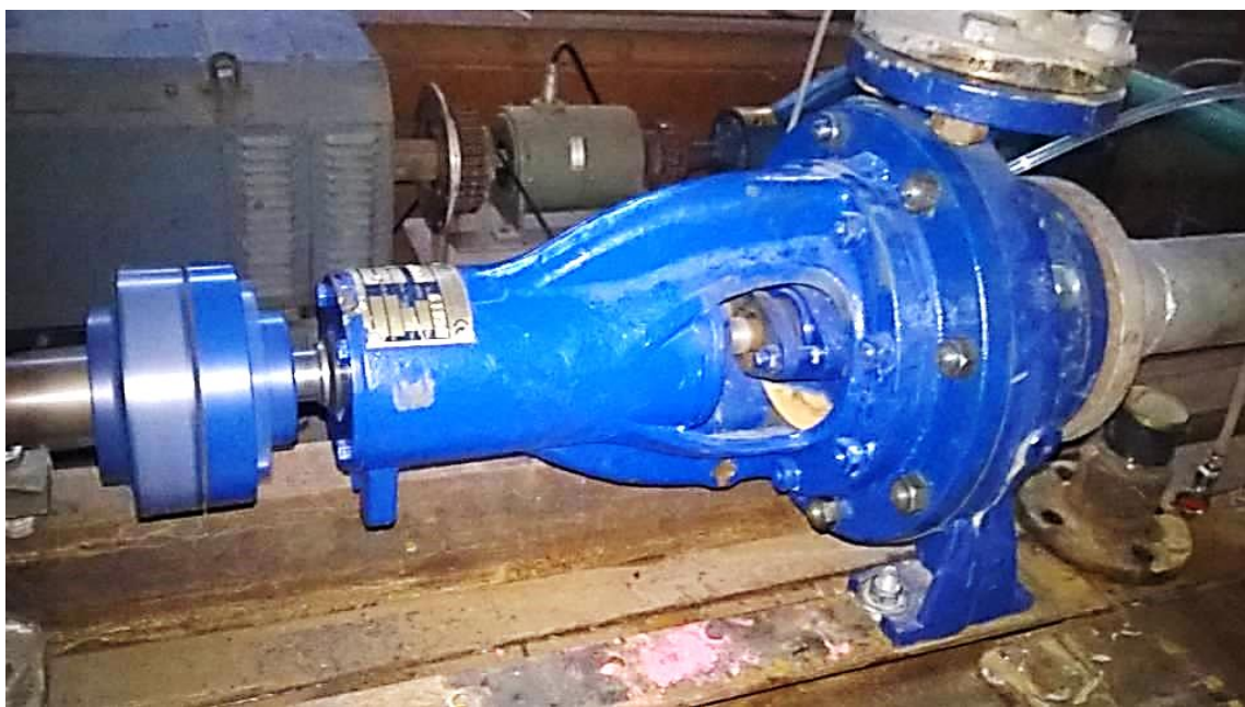
Σχήμα 8.1 Εξωτερική όψη της εξεταζόμενης αντλίας στην εργαστηριακή εγκατάσταση
