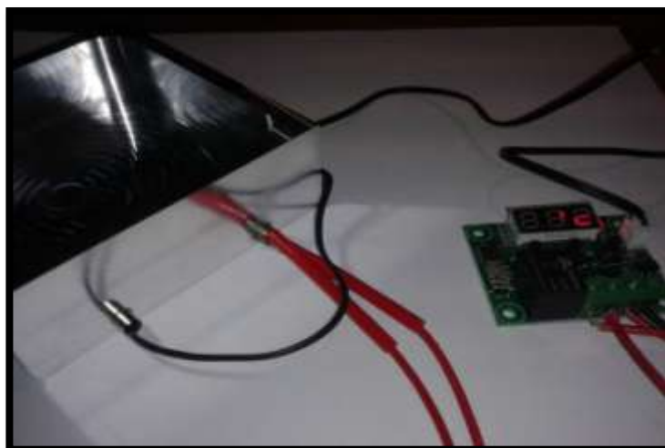
Εικόνα 50 Έλεγχος και μέτρηση θερμοκρασίας με χρήση του θερμοστάτη XH-W1209
