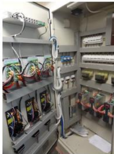
Εικόνα 27: Control Panel Unit
