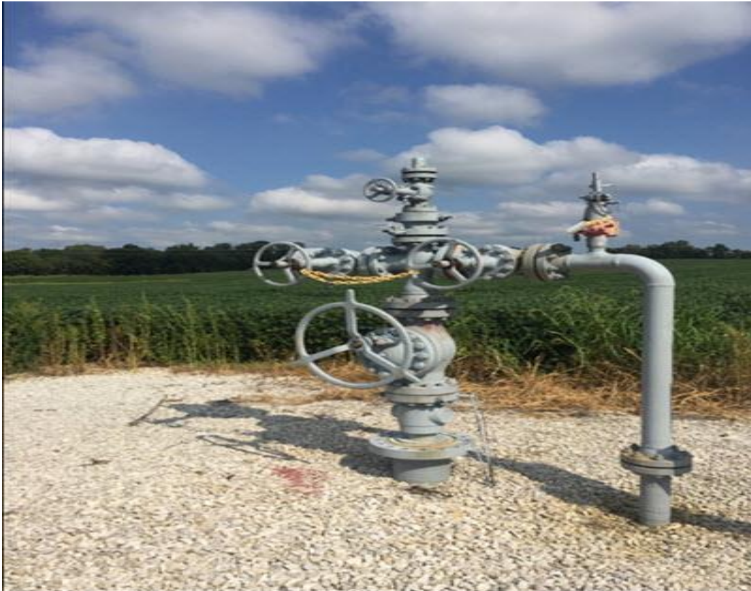
Σχήμα 1-3:Κεφαλή πηγαδιού φυσικού αερίου(wellhead)
