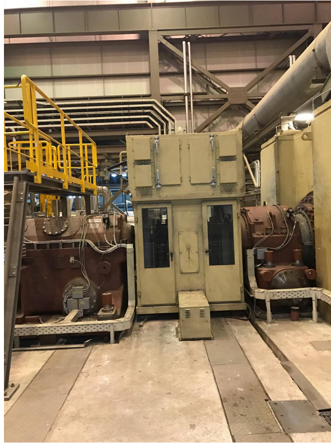
Εικόνα 5: Αριστερά ο Αεριοστρόβιλος και δεξιά ο Ατμοστρόβιλος του Αλιβερίου.
