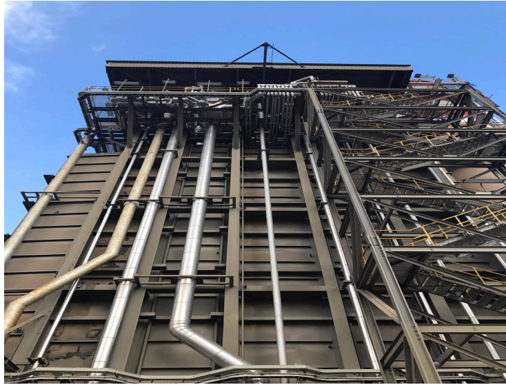
Εικόνα 1: Εξωτερική άποψη του συμπυκνωτή.
